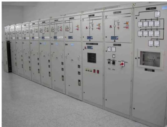
RPS для трамвайной подстанции в Кракове (Польша).
